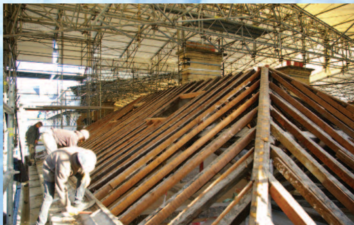
Les compagnons travaillent en sécurité et à l'abri des intempéries sous la bâche qui réverbère la lumière.
