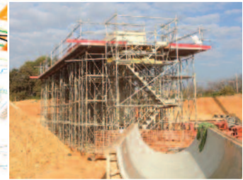
Palée d'étalement Mills Tour avec escalier d'accès sur les piles d'un pont.
