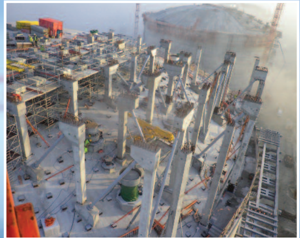
Les Touréchaf sont implantées avec précision sur des plots bétons au sommet du dôme.
