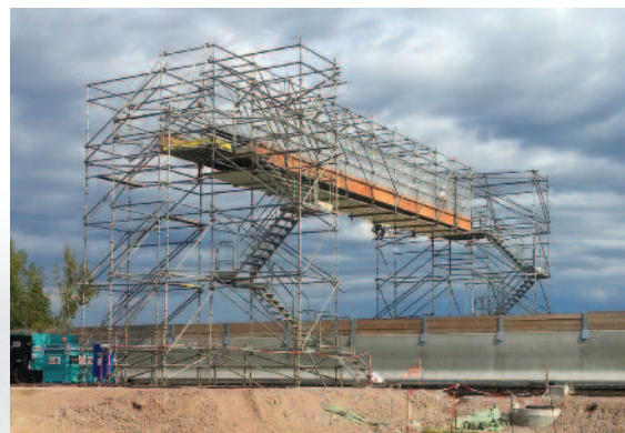
Passerelle pour permettre au personnel de circuler de part et d'autre de l'A10.
