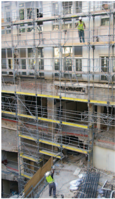
Les échafaudages de façades Mills Acram Mds sont montés en sécurité dans les cours intérieures.
